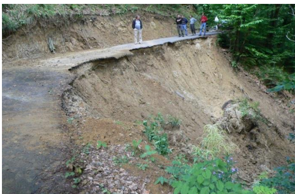
Slika 3.4. Štete na prometnici koje je izazvalo klizište u Općini Bednja.
