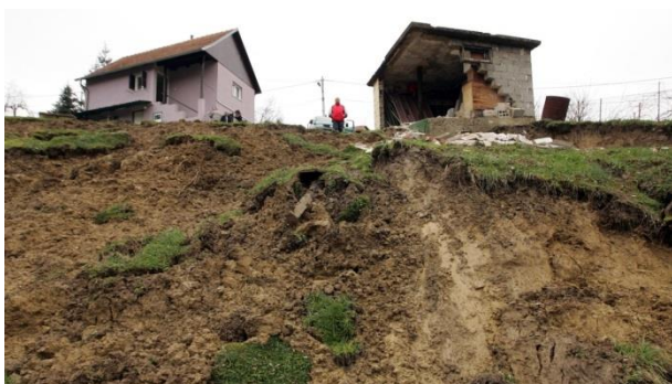
Slika 3.6. Štete na pomoćnim objektima i na okućnici izazvane aktiviranjem klizišta 2013. godine u Gradu Zagrebu.
