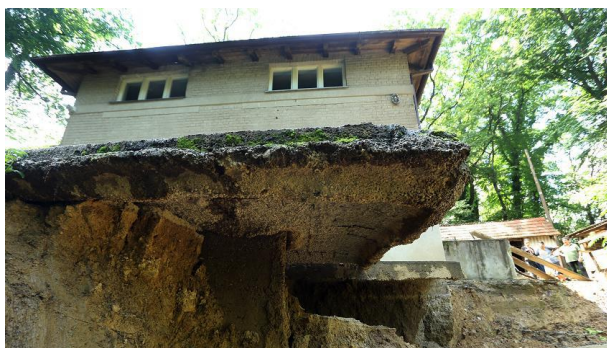
Slika 3.7. Štete na obiteljskom kući izazvane aktiviranjem klizišta u Grmoščica Desna 2013. godine u Gradu Zagrebu.
