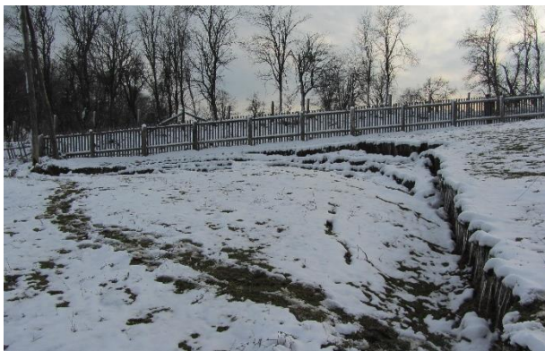
Slika 3.2. Štete na njivi koje je izazvalo klizište Zrinska Draga u Općini Dvor 2018. godine.
