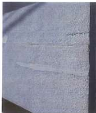
Manestri 56, oštećena fasada
