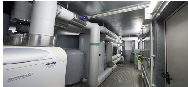
Primjer ugradnje ITPS-a zidne ugradnje pri renovaciji unutar stana na lokaciji starog bojlera:
