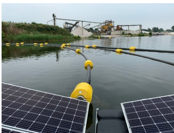
a) plutajući energetske kablovi
