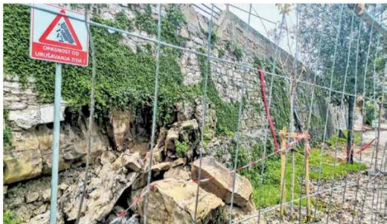
Potporni zid na Kolovarama treba hitnu sanaciju
